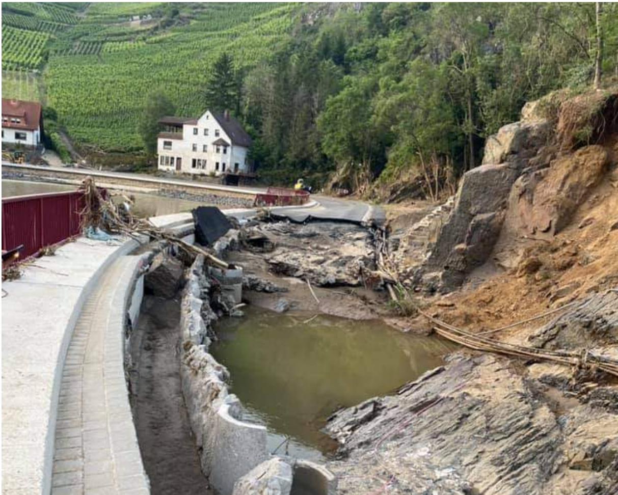
Abb.24: Hochwasserschäden in Rimerzhoven
