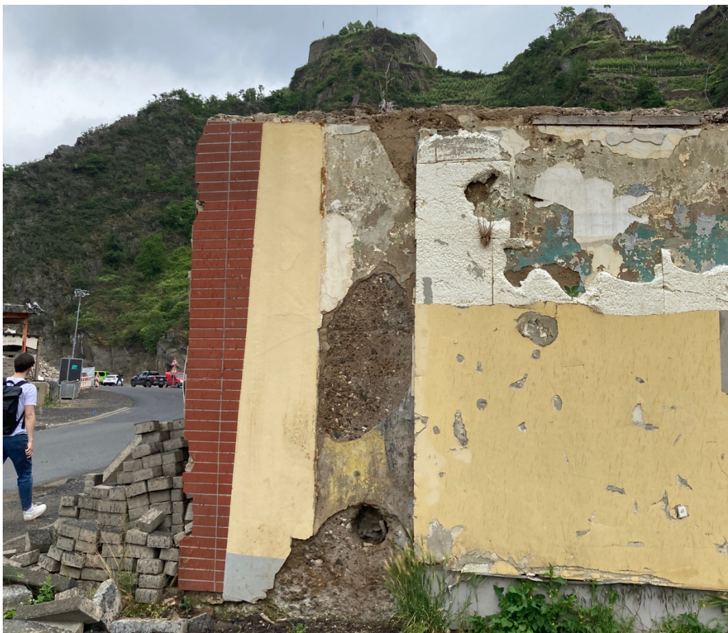
Abb.23: Hochwasserschäden in Mayschoß
