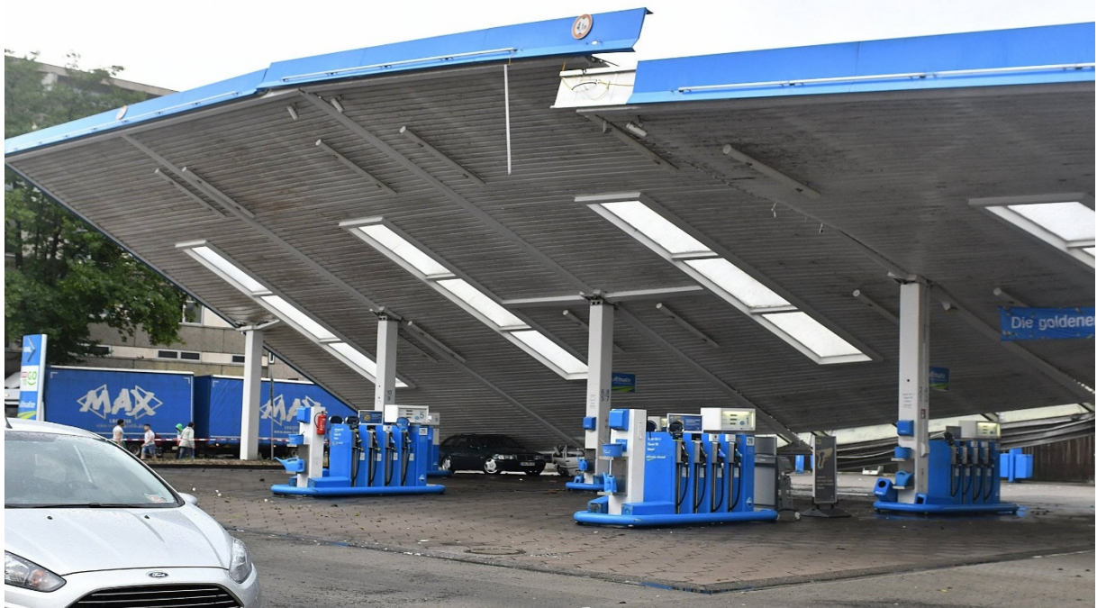
Abb.38: Ein zerstörtes Tankstellendach in Folge des Starkregenereignis 2018
